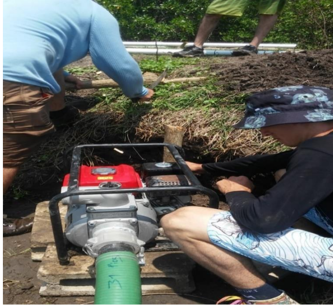
Figura A – 7. Modificación de bomba achicadora.
