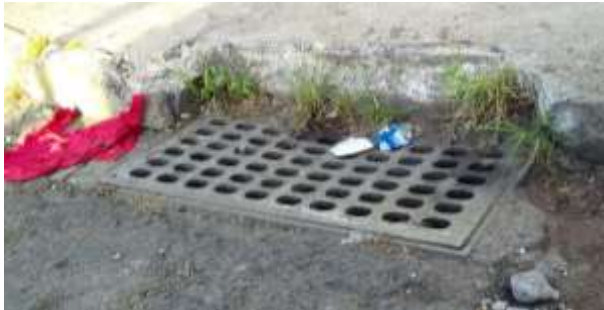
IMAGEN 18: RECOLECTOR DE AGUAS LLUVIAS
