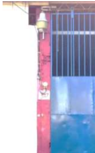
IMAGEN 21: ACOMETIDA DE LUZ ELECTRICA
