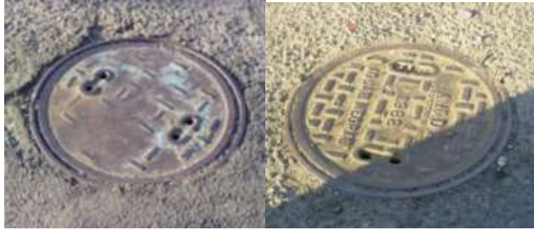
IMAGEN 17: POZOS DE SISTEMA DE AGUAS NEGRAS
