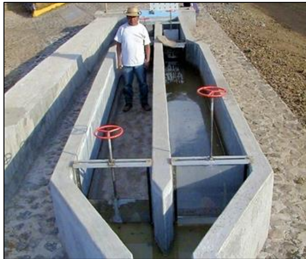
Figura 2.7 Desarenador – etapa de pretratamiento
