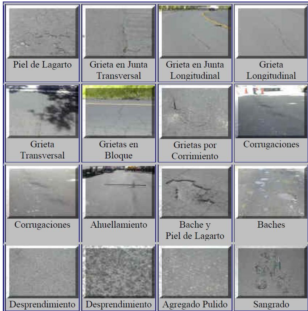
Imagen 2.13: Daños típicos de superficie de pavimentos.
