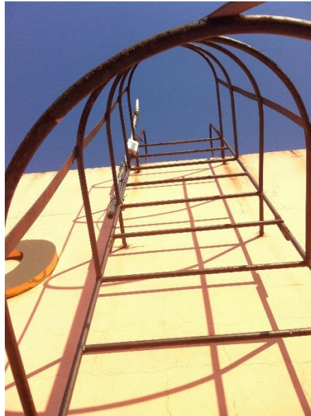
Figura 2: NS2 en edificio de Escuela de Arquitectura
