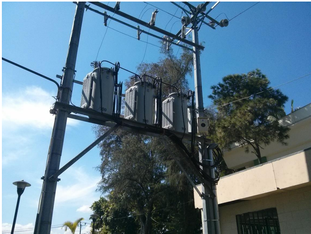
Figura 17: Medidor Odontología 1 (subestación No. 24)
