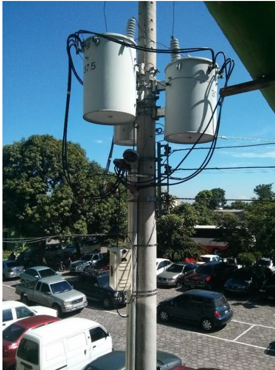
Figura 16: Medidor Auditorium Química (subestación No. 21)
