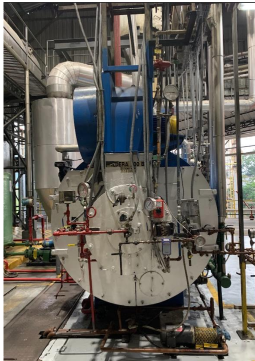
Figura 10.4. Automatización en el sistema de purgas
