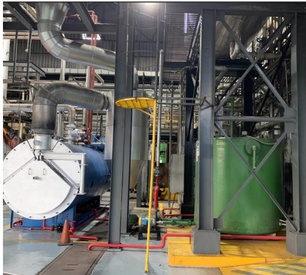
Figura 10.1. Orden y limpieza del área
