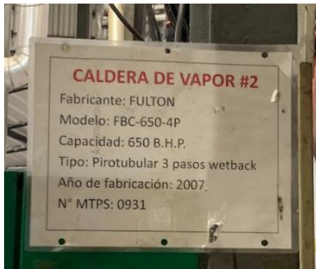
Figura 10.2. Identificación de las calderas
