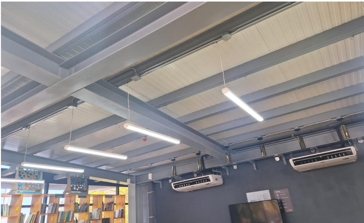
Figura A.9: Luminarias y equipos A/C del Centro de cómputo.
