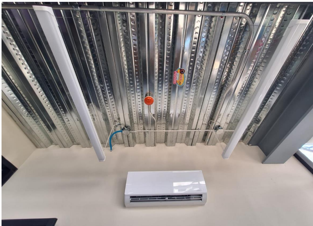
Figura A.5: Luminarias y equipos A/C de la Oficina.
