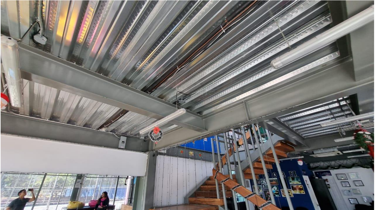
Figura B.3: Tipos de luminarias actualmente.
