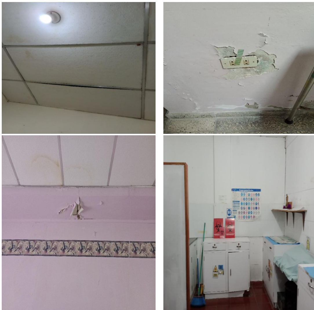
Figura 48. Evidencia de humedad, filtraciones y moho
