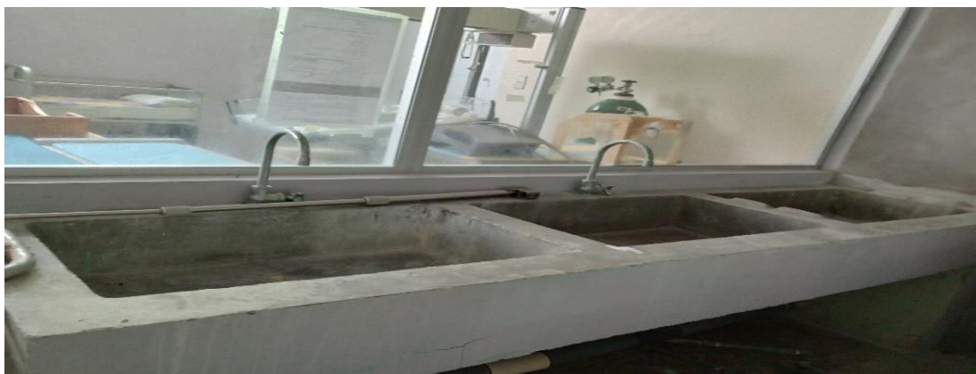
Figura 42. Primeros hallazgos sobre infraestructura inadecuada
