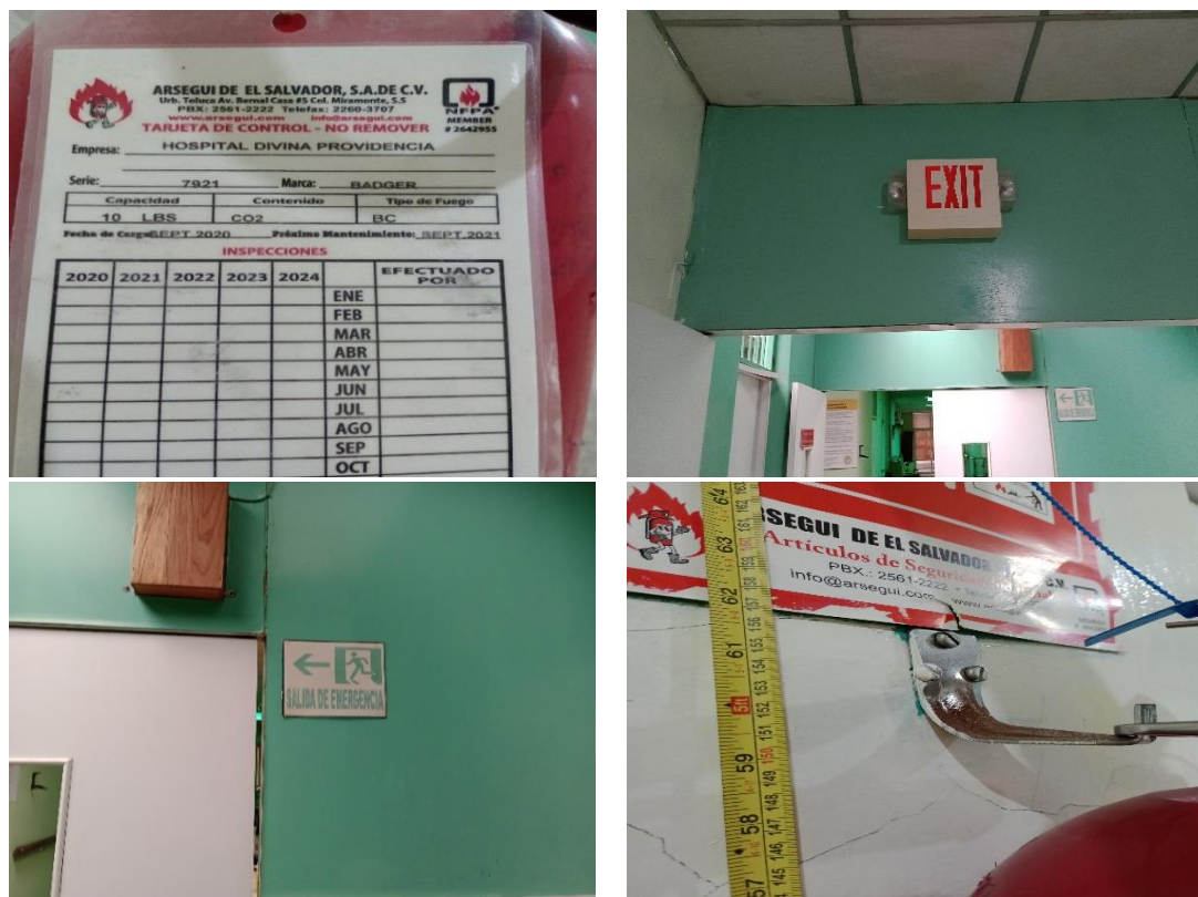
Figura 52. Evidencia control de incendios
