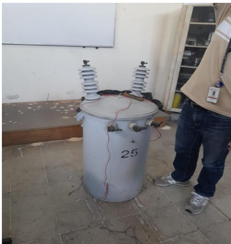
Ilustración 59 Transformador de prueba del Laboratorio de Potencia
