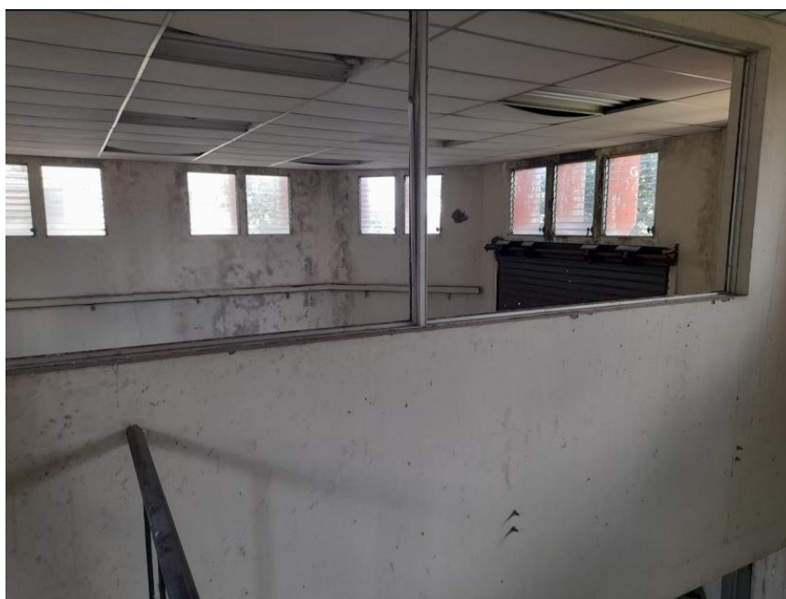
Ilustración 63 Instalaciones deterioradas del Laboratorio de Potencia.
