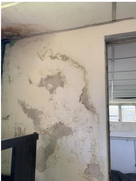
Ilustración 53 Paredes de las instalaciones del laboratorio en estado deteriorado.
