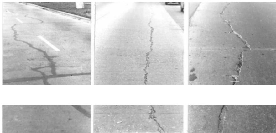
Figura. 2-8 Severidad baja, media y alta respectivamente
