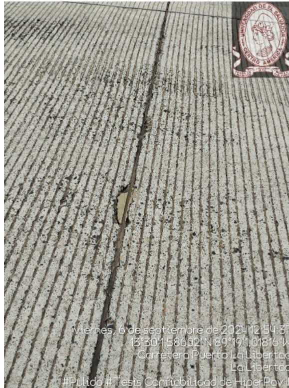
Figura. 2-11 Despostillamiento encontrado en tramo de carretera en estudio.
