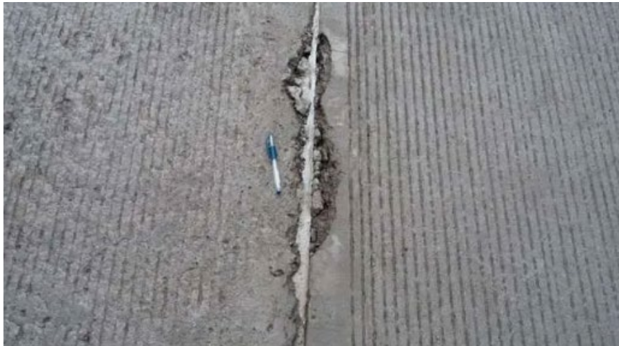
Figura. 2-10 Despostillamiento de juntas transversales.
