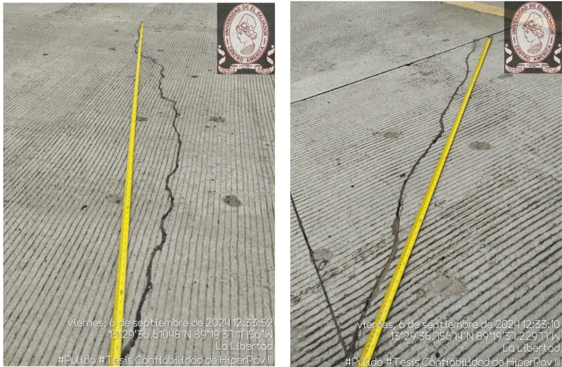
Figura. 2-9 Daño por agrietamiento longitudinal encontrado en Tramo de carretera en estudio
