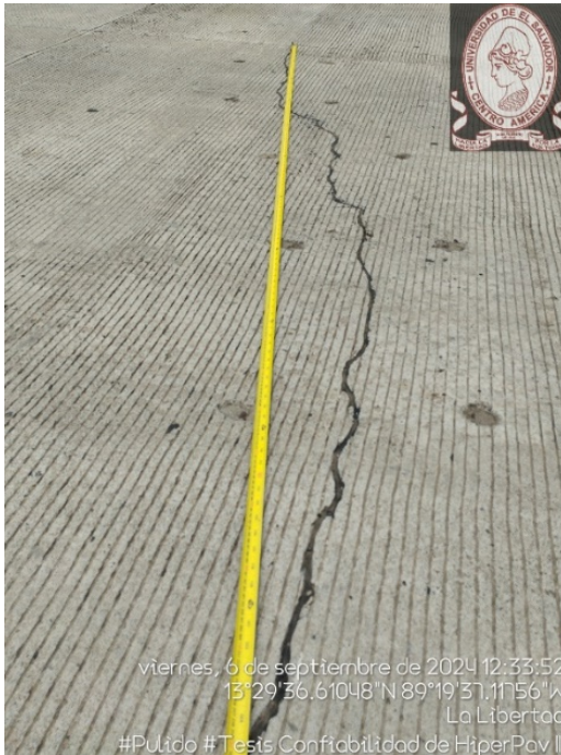
Figura. 2-13 Daño por agrietamiento trasversal encontrado en carretera en estudio.
