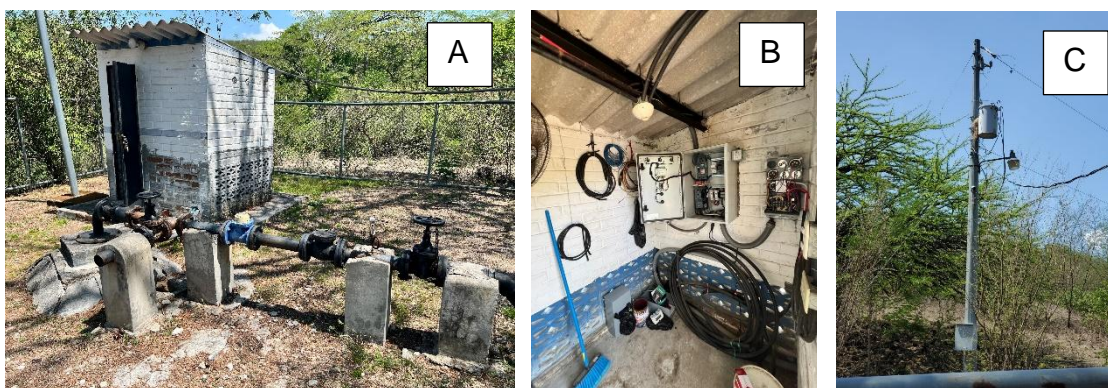
Figura 15. A) Pozo de extracción de agua. B) Casa de control eléctrico. C) Acometida eléctrica de Distrito El Sauce. Elaboración propia.
