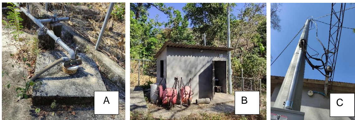
Figura 12. A) Pozo de extracción de agua. B) Casa de control eléctrico. C) Acometida eléctrica. Elaboración propia.
