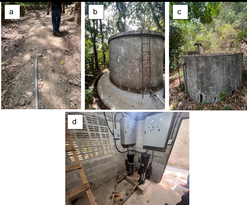
Figura 5. a) Tubería de hierro galvanizado de 2 pulg. De diámetro. b) Tanque de captación de 8 m 3 . c) Tanque de captación de 15 m 3 para distribución por gravedad. d) Estación de bombeo. Fuente propia.
