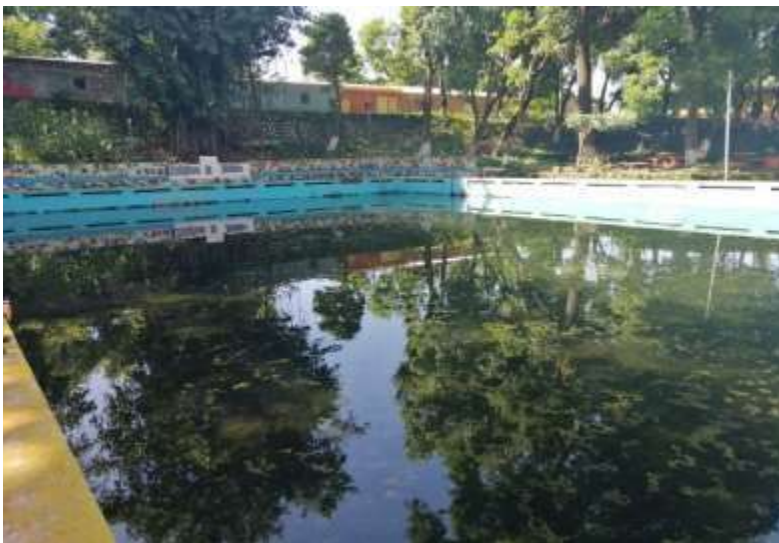
Imagen 45 Estado actual de la piscina olímpica.
