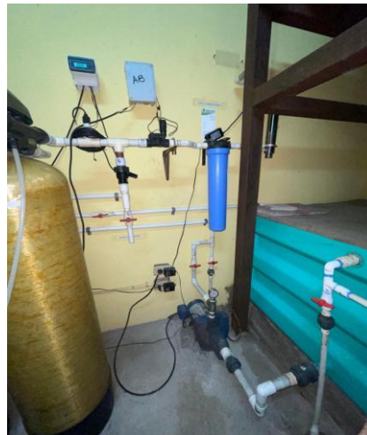
Figura N°19. Vista amplia de bomba de agua, filtros y tuberías. Fuente: Elaboración propia
