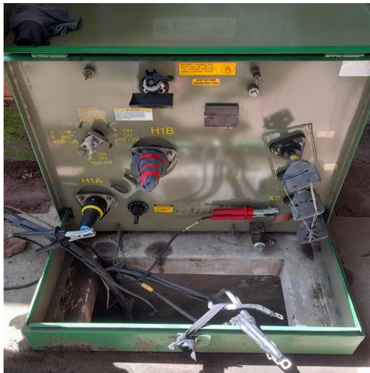
Figura 3.17: Realización de prueba de aislamiento en transformador PAD MOUNTED 2 de 50 kVA
