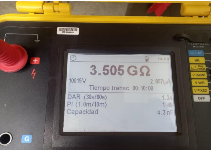
Figura 3.13: Resultado de prueba de aislamiento, conexión primario a secundario transformador 4
