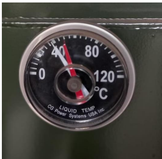
Fig. 3.14: Termómetro de transformador PAD MOUNTED 1
