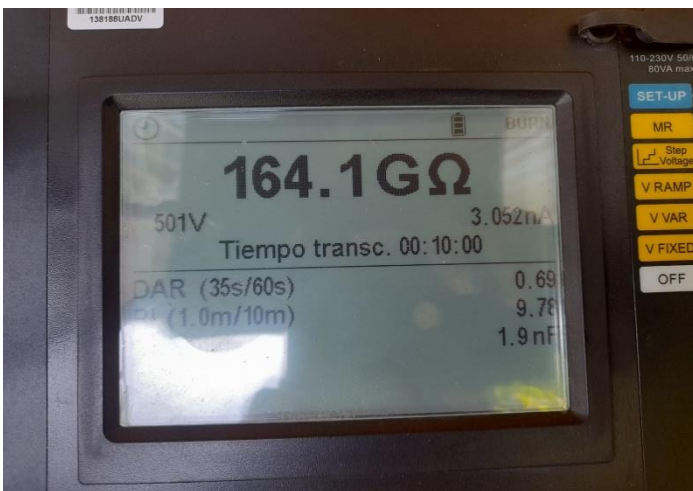
Figura 3.19: Resultado de prueba de aislamiento, conexión secundario a tierra transformador PAD MOUNTED 2
