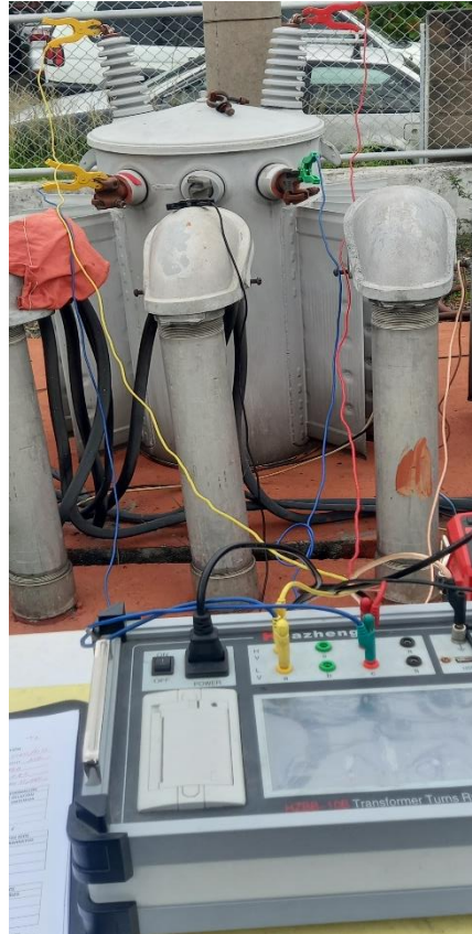
Figura 3.25: Realización de prueba de relación de transformación del transformador de distribución 3 de 100 kVA
