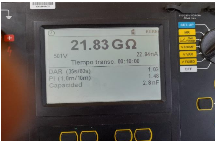
Figura 3.4: Resultado de prueba de aislamiento, conexión primaria a secundario transformador 1
