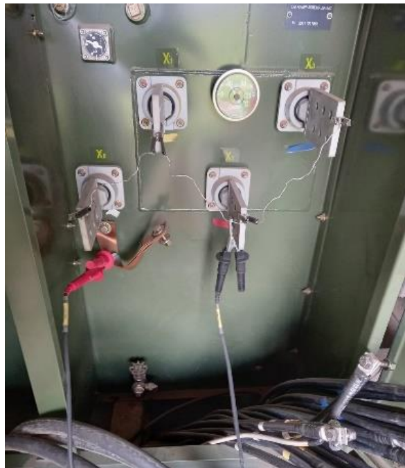
Figura 2.17: Conexión secundario a tierra con equipo AEMC 6555 -PAD MOUNTED
