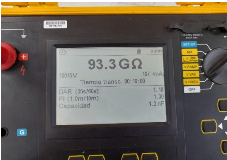
Figura 3.3: Resultado de prueba de aislamiento, conexión secundaria a tierra transformador 1
