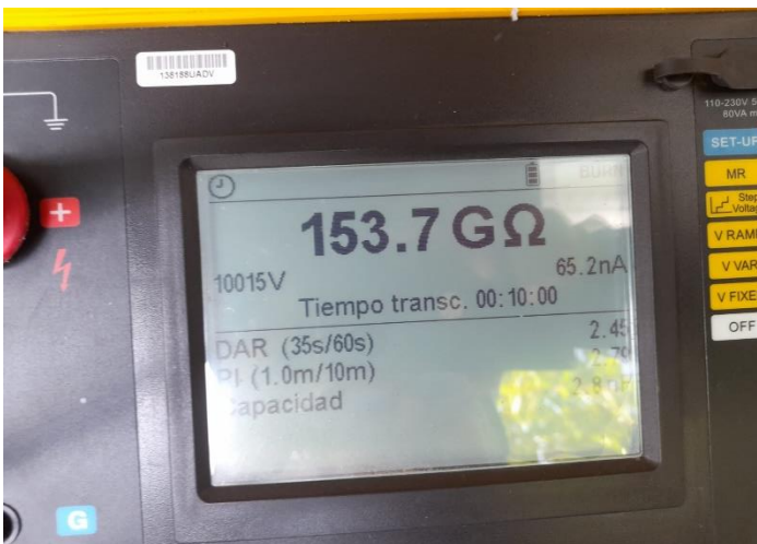
Figura 3.20: Resultado de prueba de aislamiento, conexión primario a secundario transformador PAD MOUNTED 2
