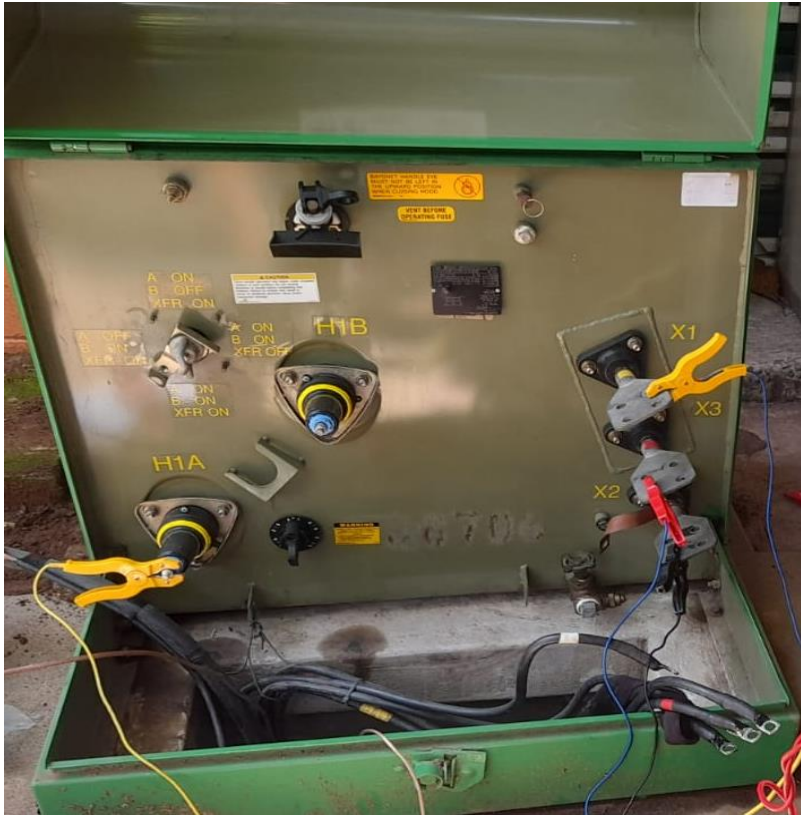
Figura 3.30: Realización de prueba de relación de transformación a transformador PAD MOUNTED 2 de 50 kVA
