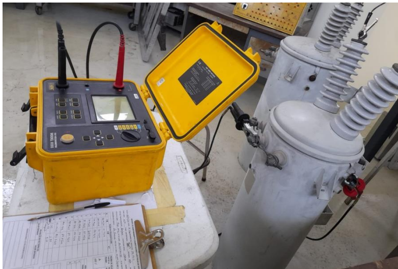
Figura 2.13: Conexión secundario a tierra con equipo AEMC 6555
