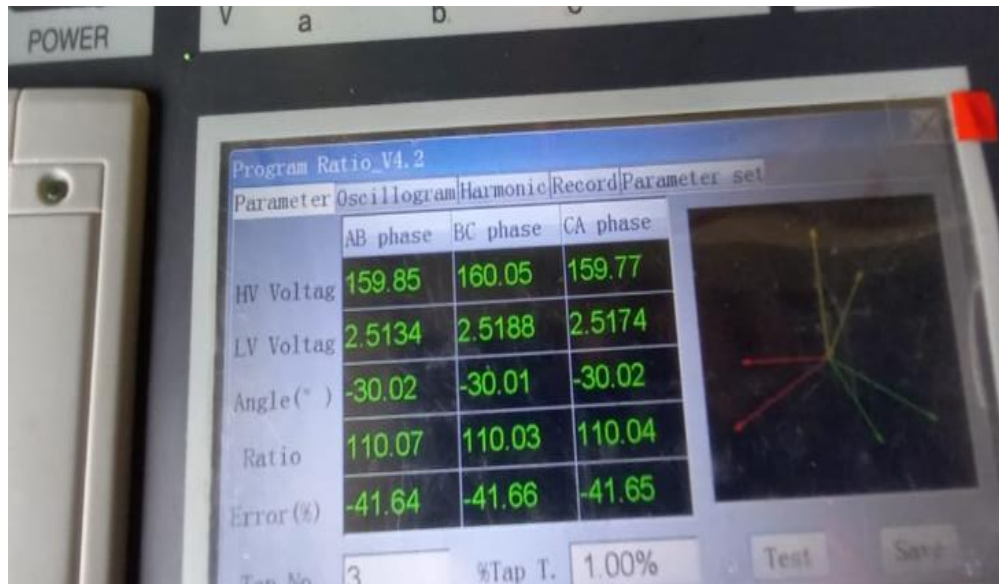
Figura 3.29: Resultado de la prueba de relación de transformación del transformador PAD MOUNTED 1 de 500 kVA
