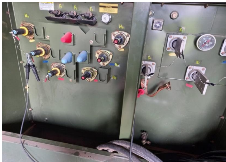
Figura 3.15: Realización de prueba de aislamiento en transformador PAD MOUNTED 1 de 500 kVA
