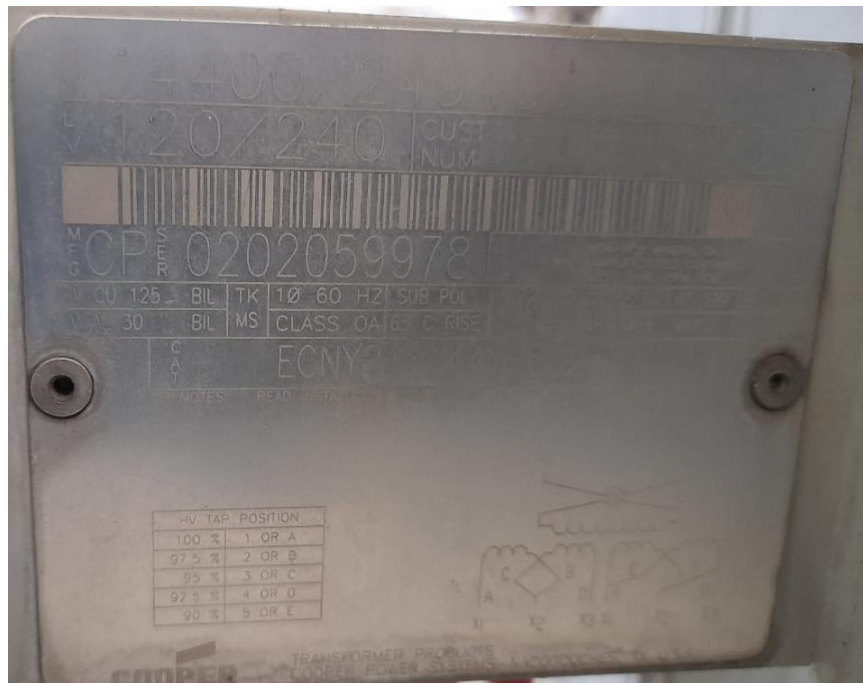
Figura 2.2: Datos de placa del transformador 2 de 25 kVA.
