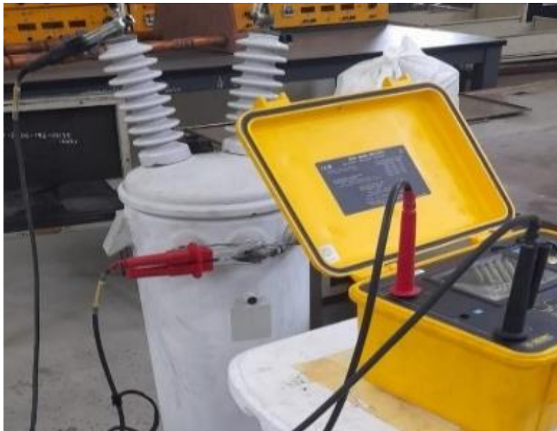
Figura 2.11: Conexión primario a secundario con equipo AEMC 6555
