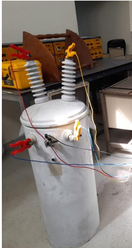
Figura 3.23: Realización de prueba de relación de transformación a transformador de distribución 2 de 25 kVA
