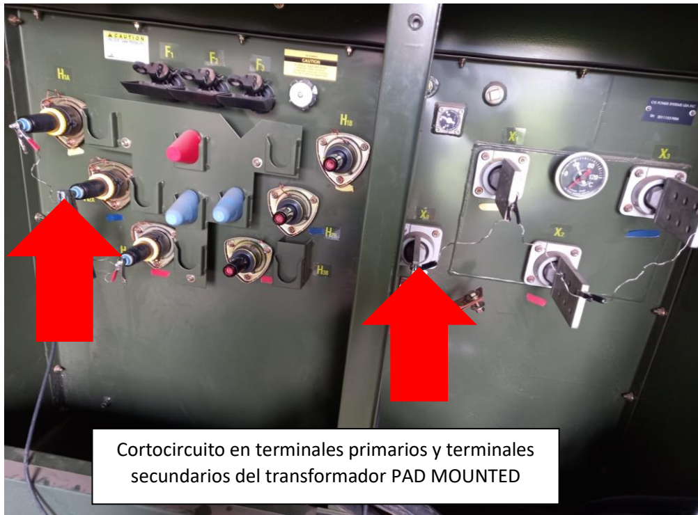
Figura 2.14: Cortocircuito en terminales de transformador PAD MOUNTED
