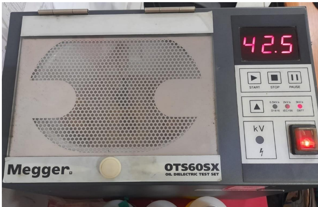
Figura 3.37: Primer resultado de rigidez dieléctrica transformador 2
