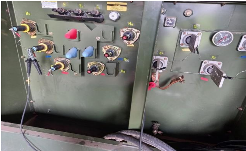
Figura 2.16: Conexión primario a tierra con equipo AEMC 6555 – PAD MOUNTED
