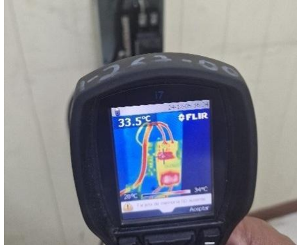
Figura 3.2 Medición de temperatura de subtablero eléctrico
