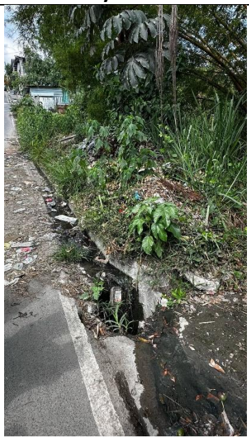
Zona de riesgo encontrada en la calle principal de la Colonia San José 1 y 2
