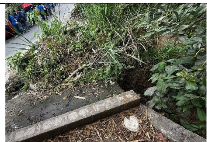
Zona de riesgo localizada también en la calle principal de la colonia San José 1 y 2
