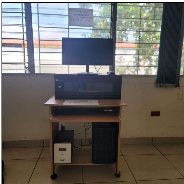
Figura 0.12 Equipo informático instalado a la estación GPS permanente.
