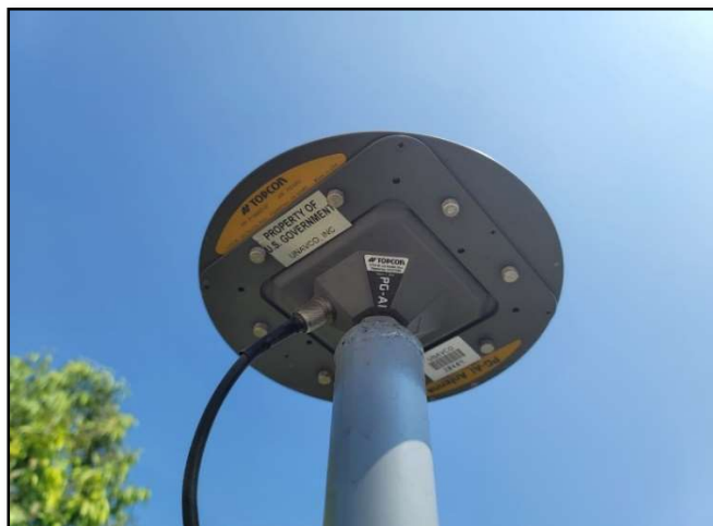
Figura 0.6 Extremo de cable coaxial conectada sobre antena.
