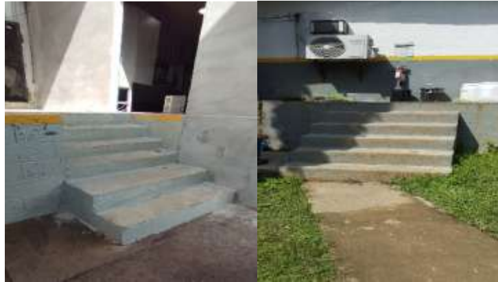
Figura 27: Falta de pasamanos en graderías
