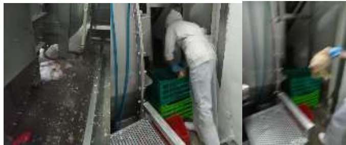
Figura 12: Riesgo de atrapamiento de miembros superiores por equipo Chillers.
