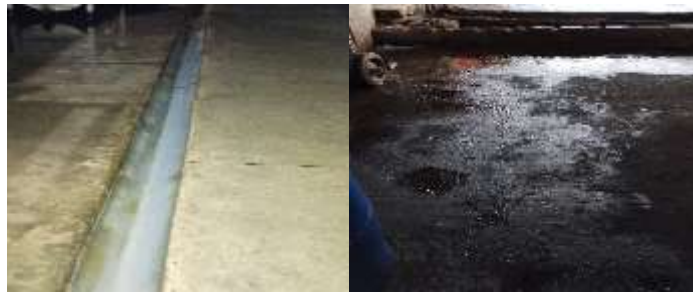
Figura 11: Falta de iluminación en área de faenado
