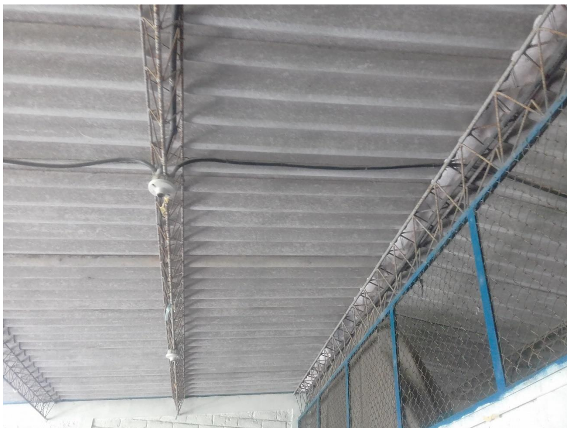
Figura 2.5. Falta de luminarias y oxidación en polines espaciales (Elaboración Propia).
