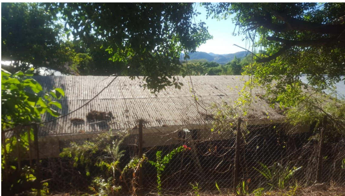
Figura 2.12 Estado actual del cerco perimetral (Elaboración Propia).
