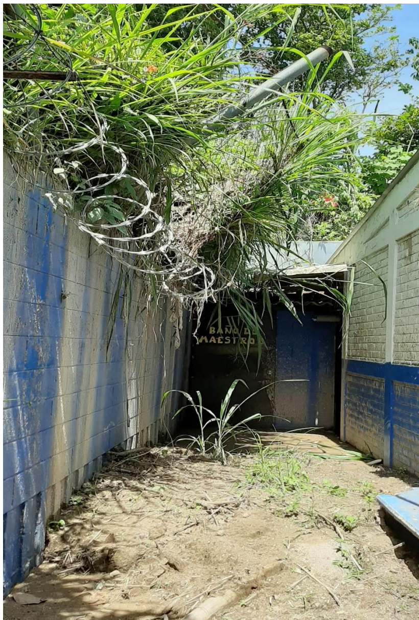
Figura 2.13 Cerco perimetral dañado debido al desprendimiento de tierra por saturación de agua en la pasada Tormenta Amanda, parte de la tierra llegó al piso del corredor (Elaboración Propia).
