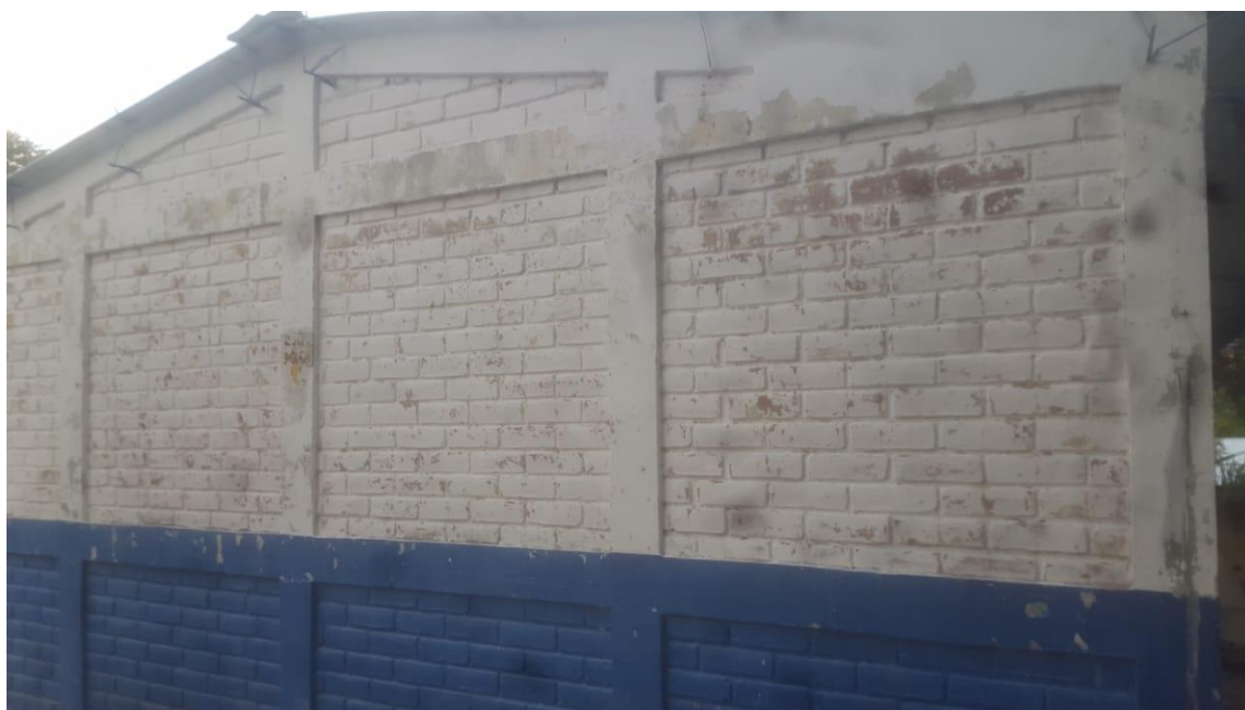
Figura 2.9 Decoloración y desprendimiento de pintura por lado externo de las paredes (Elaboración Propia).
