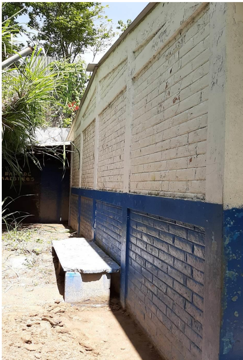
Figura 2.14 Paredes de mampostería con ladrillo de obra confinada, deterioro en pintura en los dos colores oficiales del Ministerio de Educación (Elaboración Propia).
