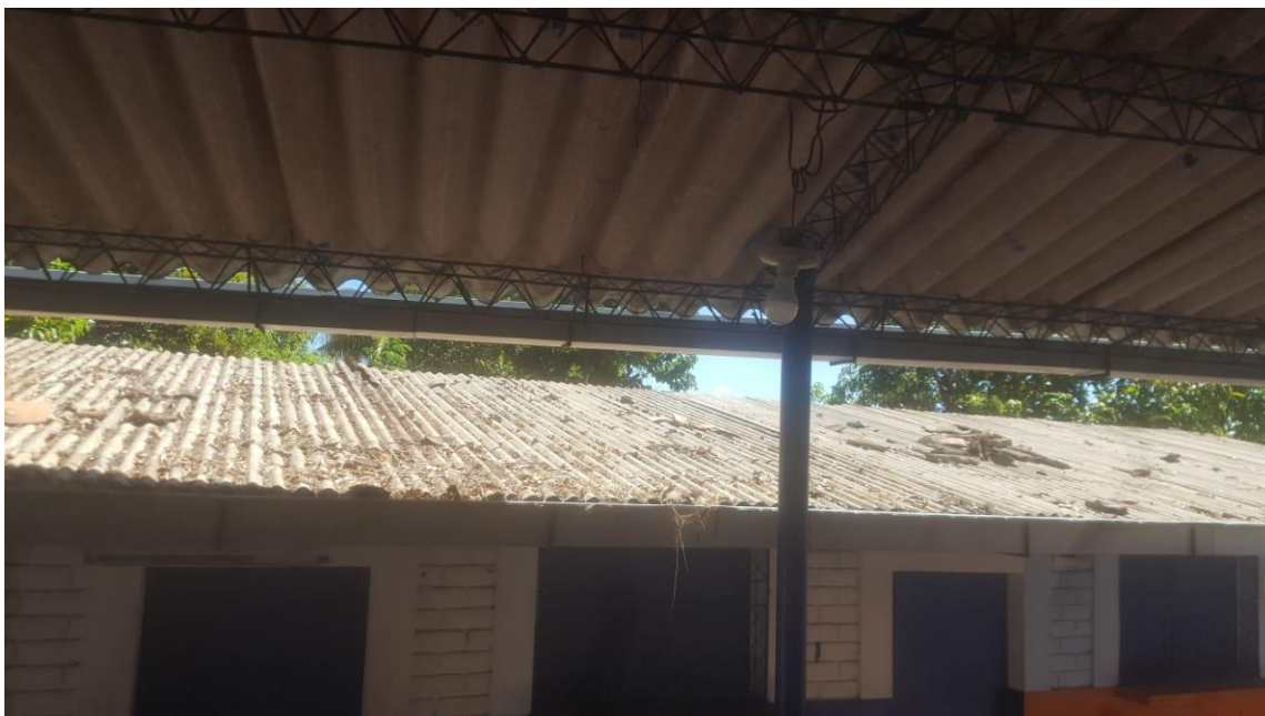
Figura 2.11 Hojas de árboles en el techo y en el canal de aguas lluvias (Elaboración Propia).
