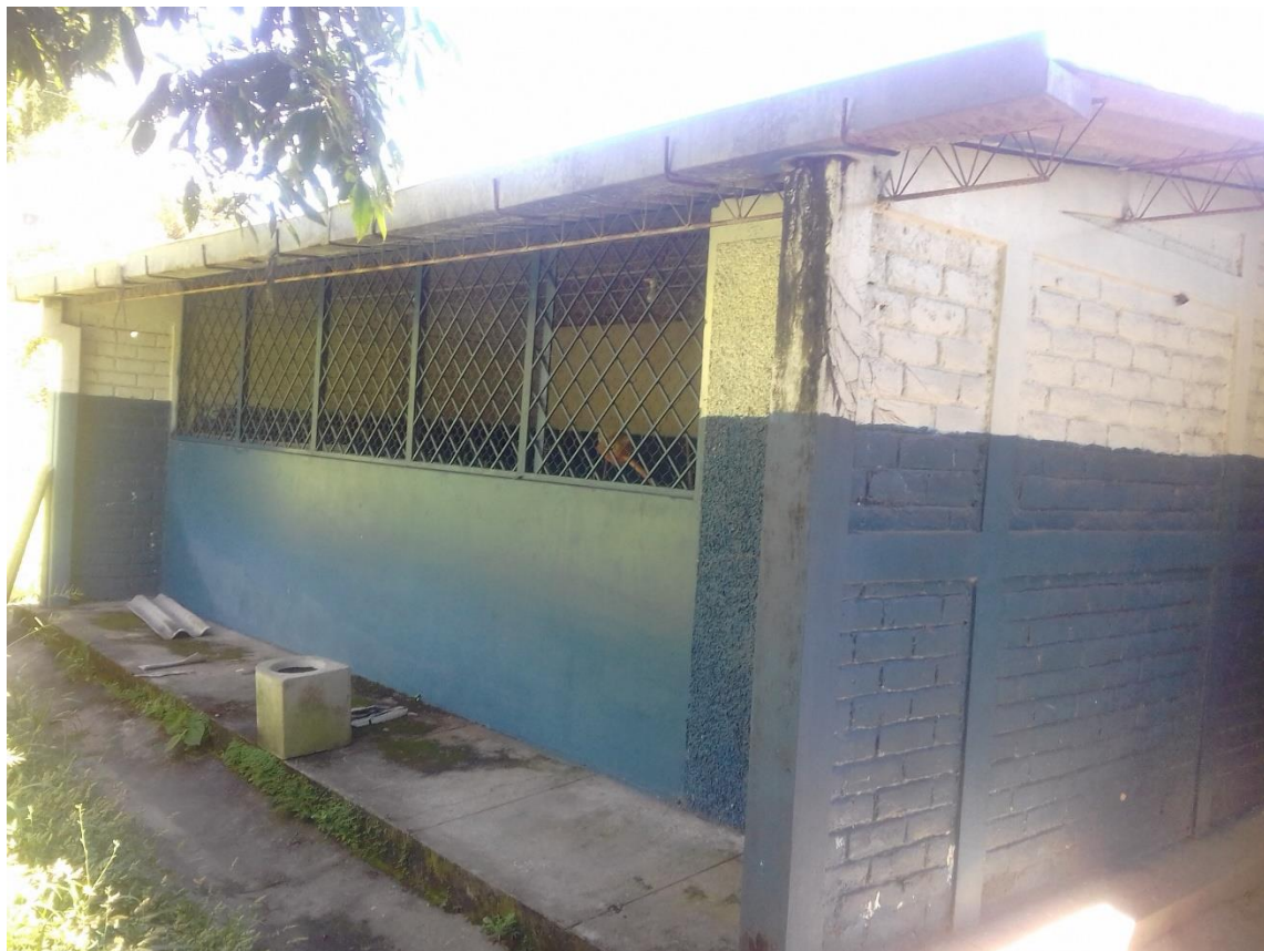
Figura 2.7. Moho en pared debido a falla de conexión entre canal y bajada de aguas lluvias (Elaboración Propia).
