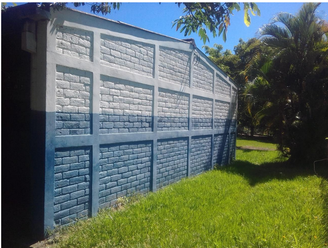
Figura 2.6. Decoloración de pintura externa en paredes de la infraestructura principal (Elaboración Propia).
