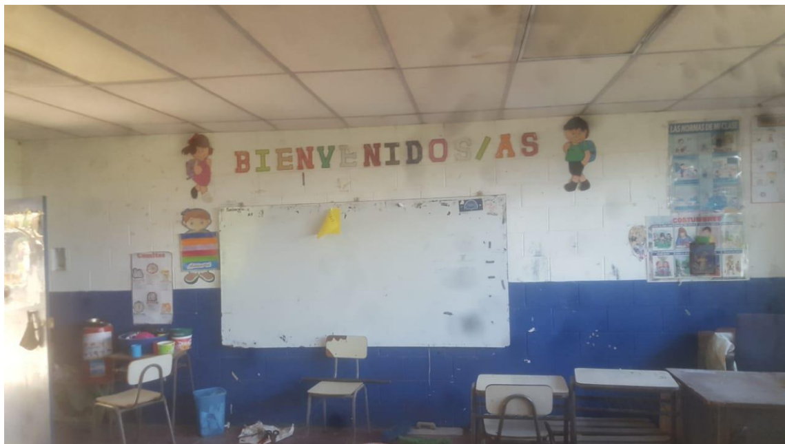
Figura 2.10 Manchas en cielo falso debido a filtraciones en la cubierta, daño en pintura de las paredes internas (Elaboración Propia).
