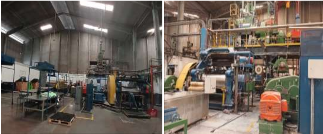
Figura 31: Instalaciones de maquinaria de Hule Duramas
