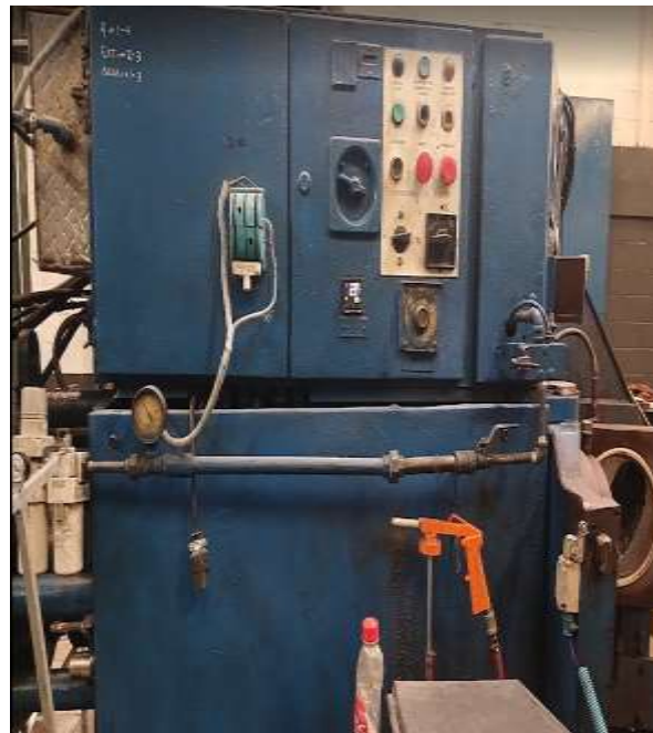
Figura 37. Maquinaria con un sistema de alarma deteriorado
