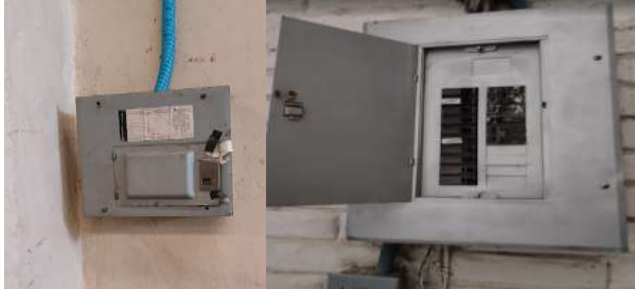
Figura 30. Tableros eléctricos sin rotulación
