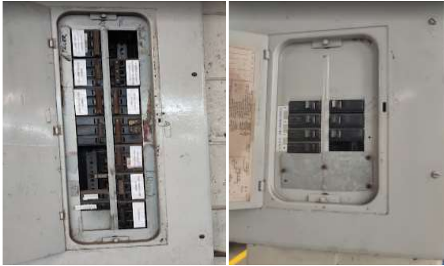
Figura 28: Tableros eléctricos sin señalización
