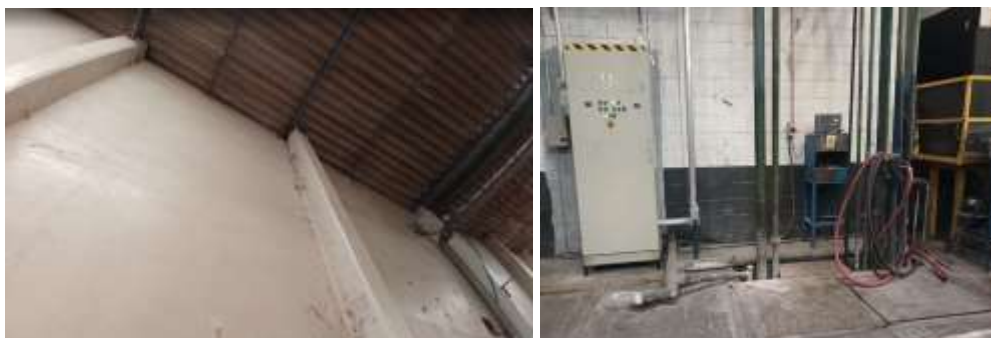
Figura 20: Paredes en malas condiciones
