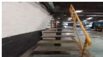
Figura 25. Escalera sin pasamanos entre la pared
