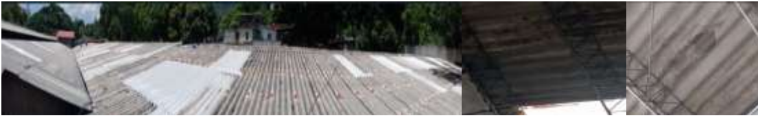
Figura 21: Techos con goteras
