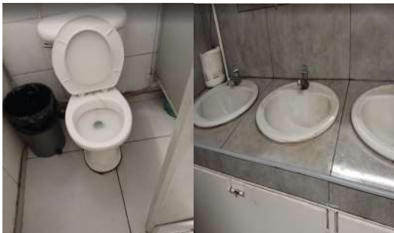
Figura 26. Baños y lavamanos
