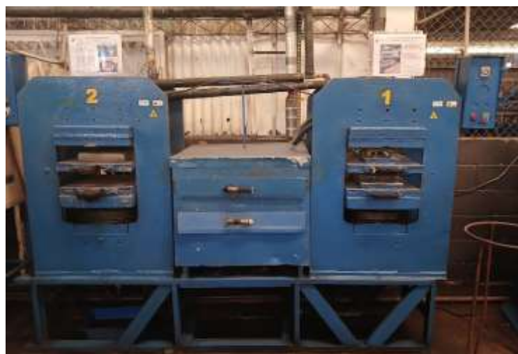
Figura 36. Maquinaria sin mecanismo de parada de emergencia
