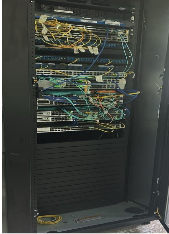
Anexo 3: Enlaces Principales Ubicados en El Datacenter.
