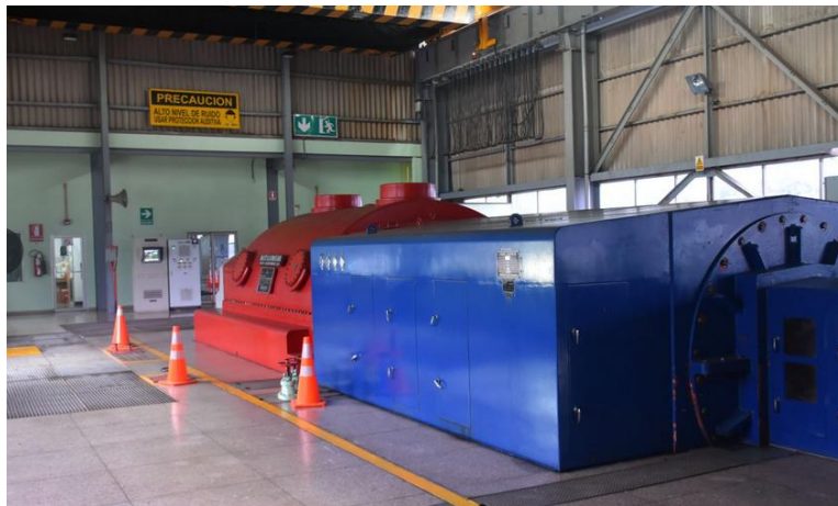
Generador y Turbina Mitsubishi 30 MW
