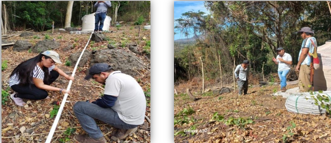
Figura 8. Instalación de riego por goteo a productora beneficiaria del proyecto FIDEAGRO en cantón Las Ánimas.
