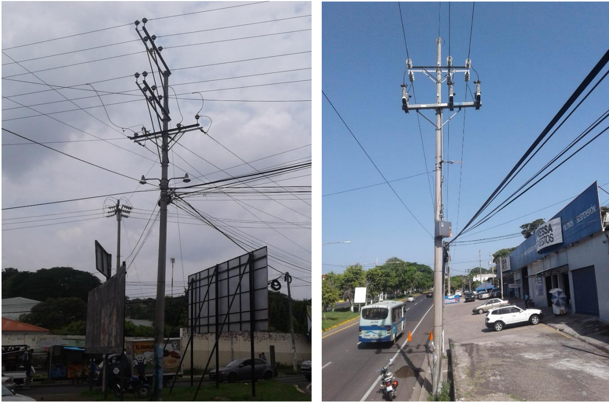
Fotografía 2: Poste de tendido eléctrico de alta tensión frente a redondel Josemaria Escrivá de Balaguer.
