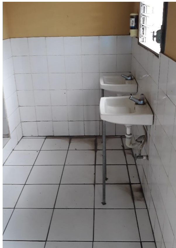
Fotografía 52: Lavabos en servicios sanitarios.
