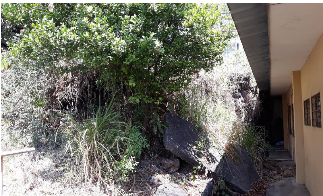
Fotografía 41: Talud entre ex crematorio y edificio N°4.
