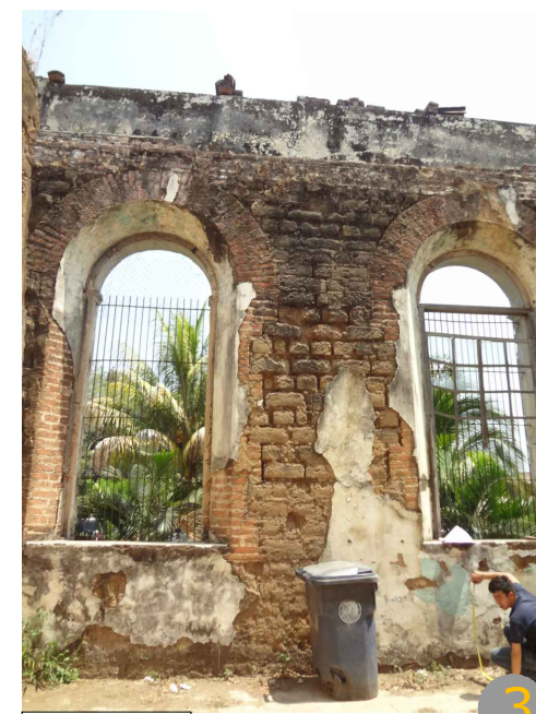
2016 Vista de pared en la zona noroeste, la pared tiene faltante de repello y daños en su estructura.
