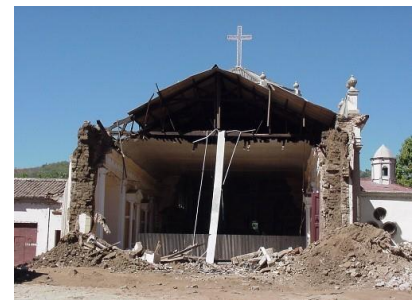
Ilustración 40. Iglesia El Calvario, Santa Ana, Terremoto 2001, Diario de Hoy.
