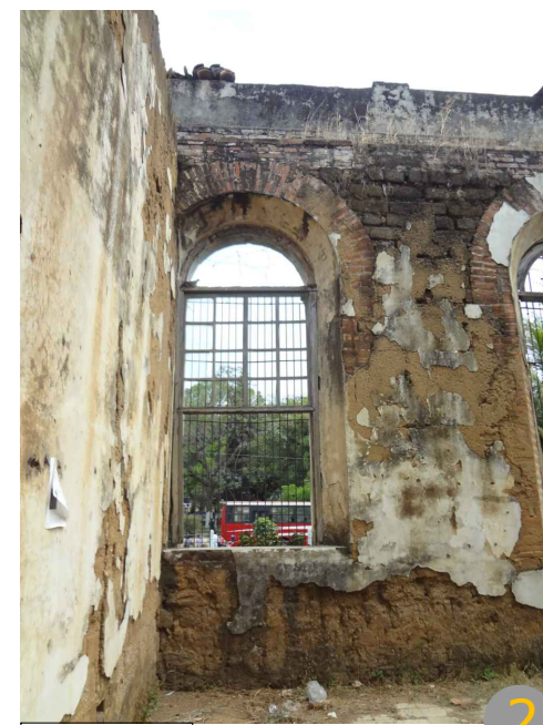
2016 Vista de pared en la zona noroeste, esta pared presenta daños en su estructura y faltante de repello.
