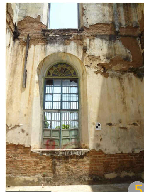
2016 Vista de vestibulo en la zona norte y parte del segundo nivel en la imagen se puede observar que la pared tiene daños en el repello.
