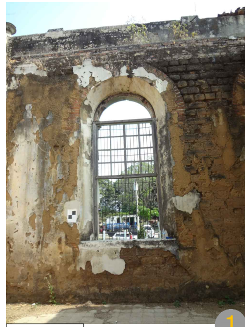
2016 Vista de pared en la zona noroeste, la cual tiene daños en su repello.
