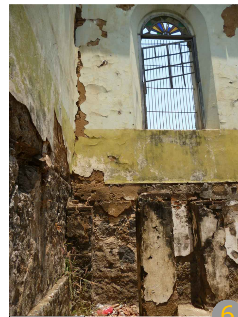
2016 Vista de un segmento del sotano, así mismo se puede observar unas columnas las cuales presentan daños en su repello.
