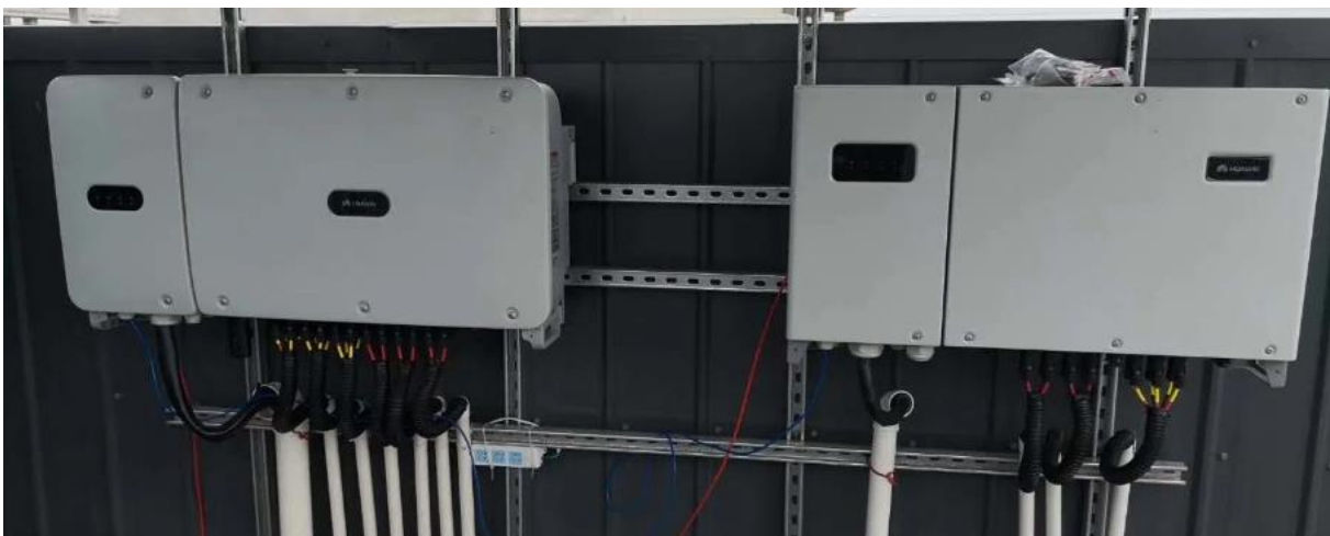
Imagen 14: detalle de dos inversores solares modelos Huawei Sun2000-100ktl-M1 de 100kW de potencia eléctrica instalados en el sector industrial. Cortesía de Made-in-China.
