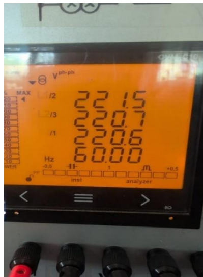
Figura 3.8. Lectura de voltaje de línea en vacío. (fuente: autores).
