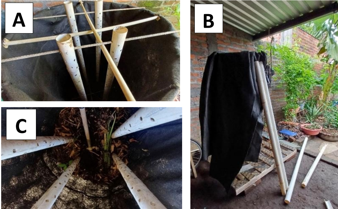
Figuras 8. Proceso de preparación de sistema de ventilación. A). Ordenamiento de 4 tubos PVC 2 ½” como sistema de airado para proceso de compostaje. B). tubos de pvc previo al proceso de elaborado de agujeros. C). fotografía de la tubería instalada en su lugar.
