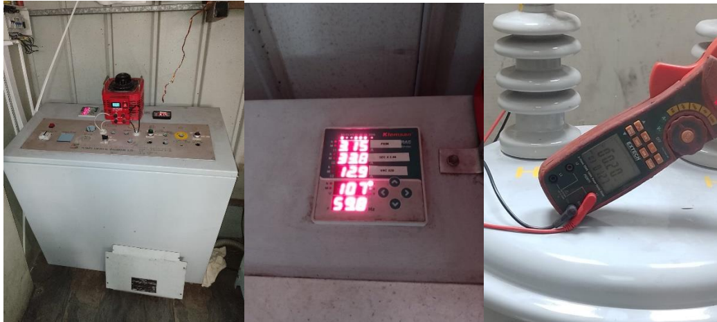
Ilustración 34. Prueba de impedancia de cortocircuito.
