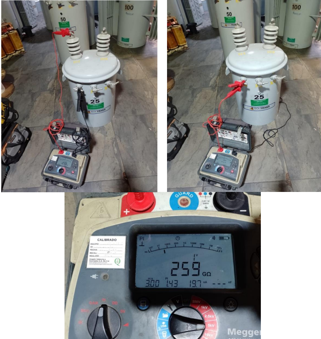
Ilustración 32. Configuración de equipo para pruebas de Aislamiento.
