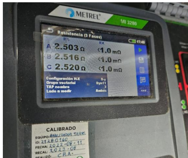
Ilustración 35. Prueba de resistencia ohmica de los devanados.
