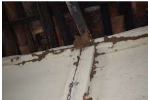
Figura 79: Detalle de nido de termitas en la estructura. Fotografía por: Valeria Martínez
