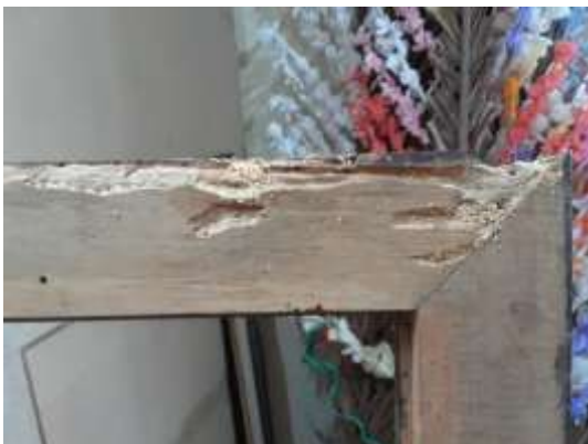
Figura 88. Detalle del deterioro del contramarco obra 1. Fotografía tomada por: Grecia Mejía
