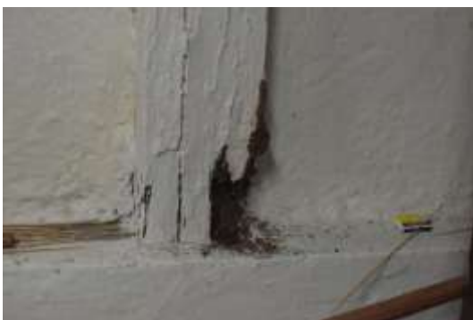
Figura 80: detalle del deterioro de la infraestructura por termitas. Fotografía tomada por: Valeria Martínez
