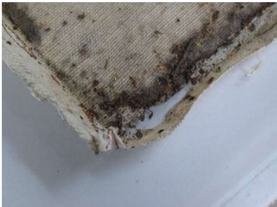
Imagen 17. Detalle del deterioro de la obra 2, esquina inferior izquierda. Fotografía tomada por: Grecia Mejía.
