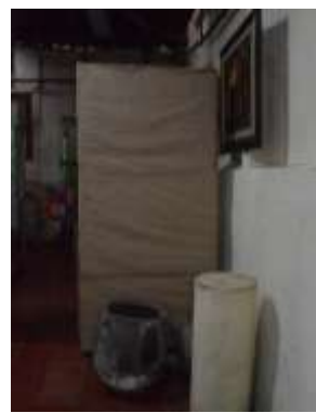
Figura 83: detalle de módulo deteriorado parte frontal. Fotografía por: Valeria Martínez
