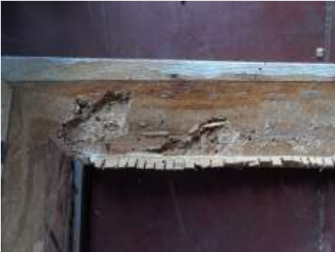
Figura 90. Detalle deterioro de contramarco obra 2. Fotografía tomada por: Grecia Mejía
