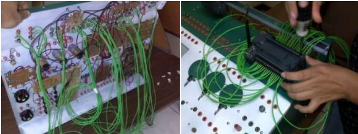
Fig. 2.31. Cableado de módulos y el PLC.
