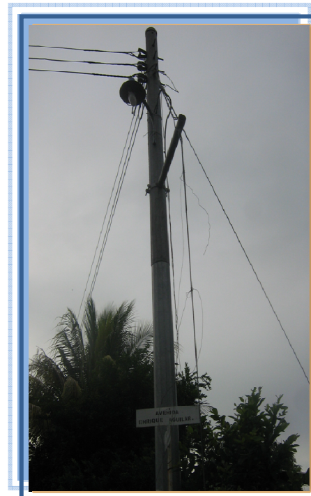
ALUMBRADO ELÉCTRICO UBICADO EN CALLE FAYSH ABOGANEN
