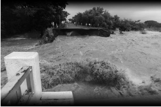
Fig. 8: Daños de la Depresión E-12
