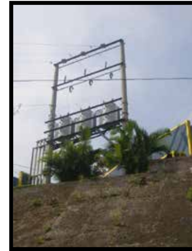
2. SUB- ESTACIÓN ELÉCTRICA
