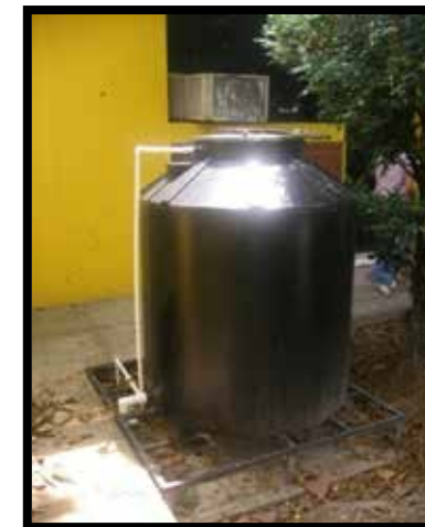
3. CISTERNA DE ROTOPLAST
