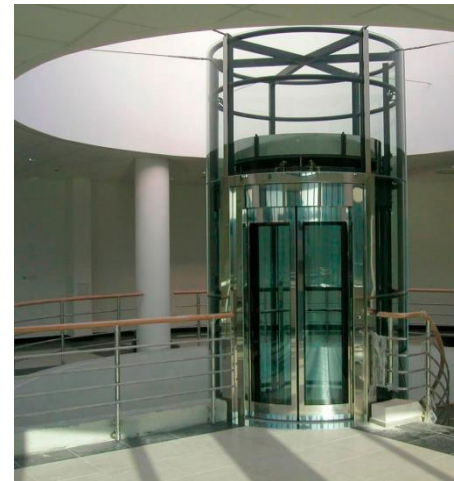
Imagen 57 Circulación Vertical, Elevador
