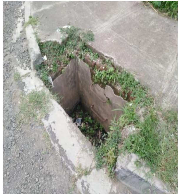
Ilustración 12 Desagües en mal estado
