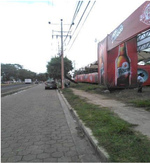
Ilustración 13 Infraestructura Eléctrica Desordenada
