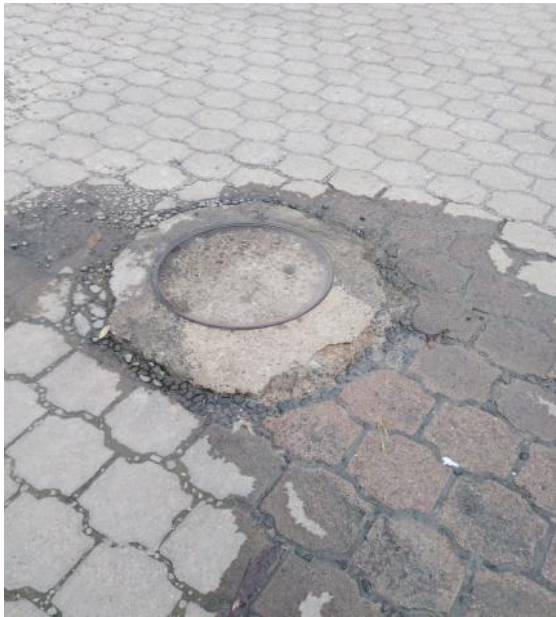
Ilustración 14 Infraestructura: Alcantarillados en mal estado y funcionamiento defectuoso
