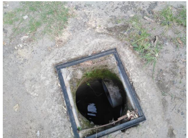
Ilustración 15 Infraestructura en mal estado, alcantarillados totalmente dañados
