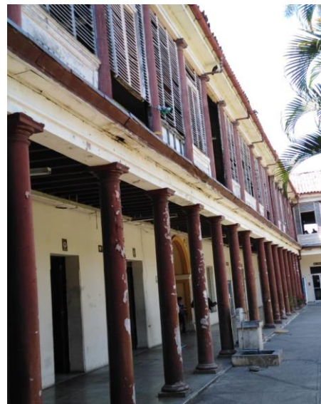
Imagen 14 Infraestructura Actual de la Alcaldía Municipal
