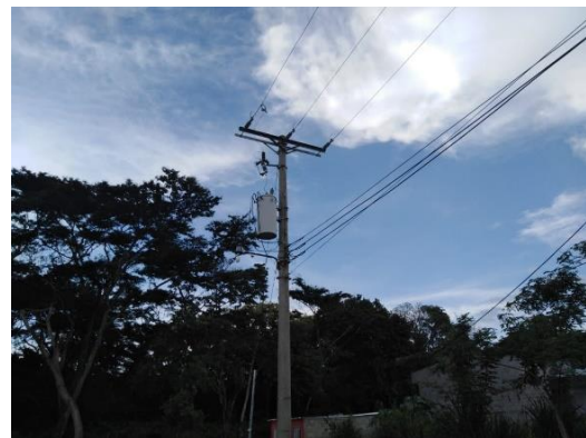
Ilustración 19 Cableado Eléctrico Imagen Urbana
