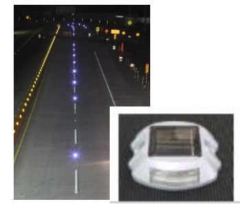
Iluminación reflectora tipo estoperoles viales
