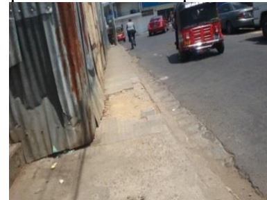
Fotografía 13: Deterioro en acera
