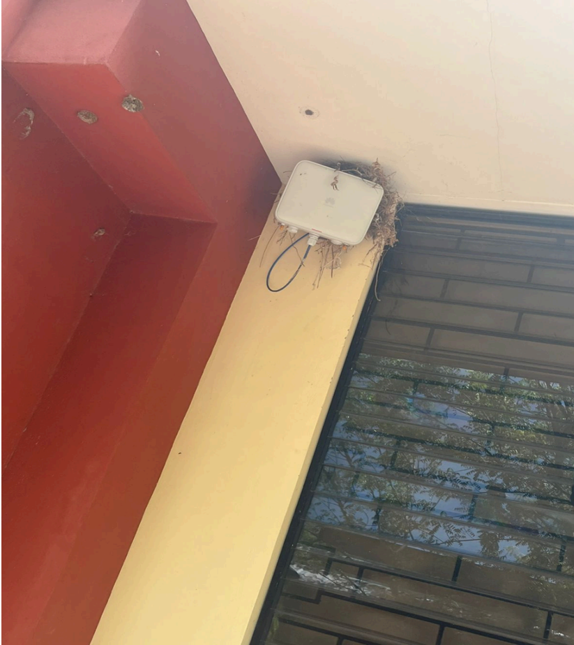
Ilustración 22.punto de distribución de red wifi
