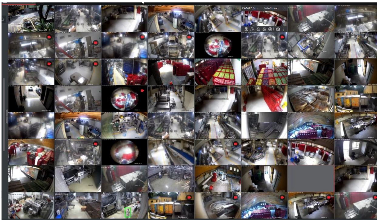
Anexo 3 videovigilancia en equipos crítico
