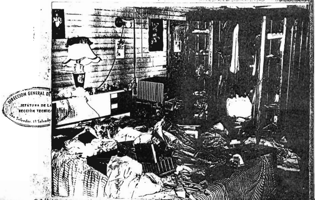
ILUSTRACION CUARTA: Fotografía tomada en el dormitorio de la señora FIDELINA FLAMENGO DE BAUME, que muestra el completo desorden en que dejaron los ladrones que asaltaron la residencia ya citada, apreciándose un reparo que fue
