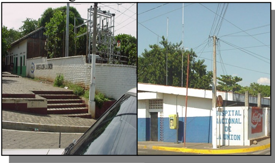
Foto N° 60: Tendido Eléctrico y subestación De La Unión.
