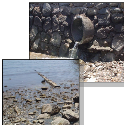
Foto N° 53: Desalojo de aguas servidas a la bahía
