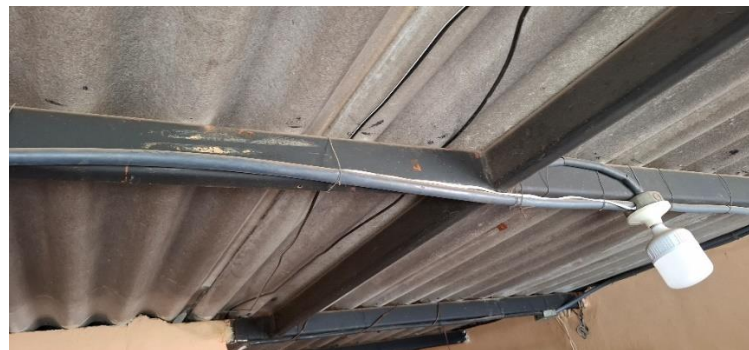
CANALIZACIONES CON POLIDUCTO REQUIERE CAMBIO
