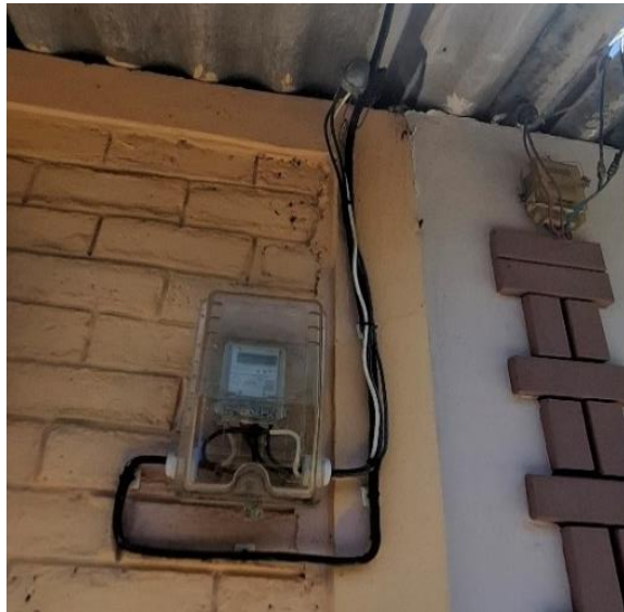
ACOMETIDA PRINCIPAL EN BUEN ESTADO
