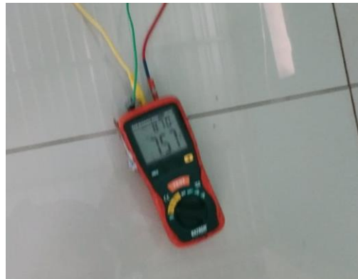
PRUEBA DE RED DE TIERRA QUE CUMPLE
