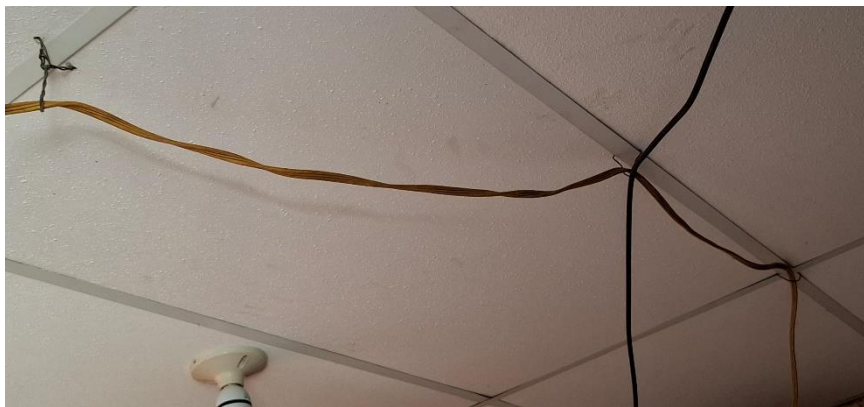
UNA PARTE CARECE DE CANALIZACION
