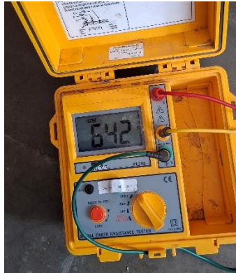
PRUEBA DE RED DE TIERRA QUE NO CUMPLE
