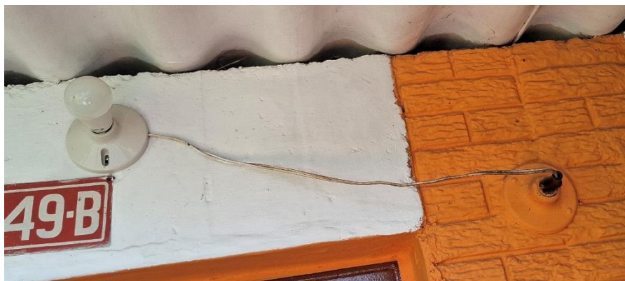
UNAS PARTES CARECEN DE CANALIZACION
