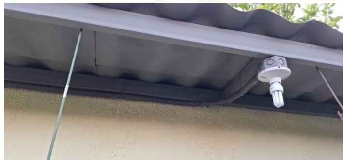
CANALIZACIONES CON POLIDUCTO AUN EN BUEN ESTADO
