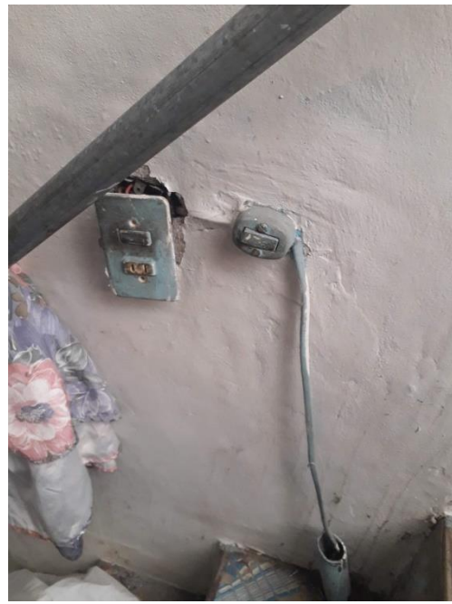
Imagen 4. Tomas de corrientes e interruptores de la época
