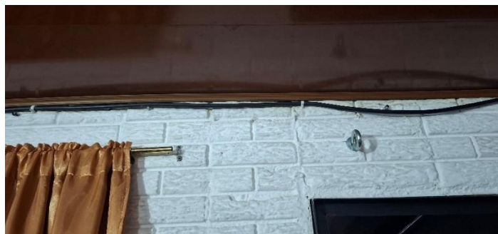
UNA PARTE CARECE DE CANALIZACION
