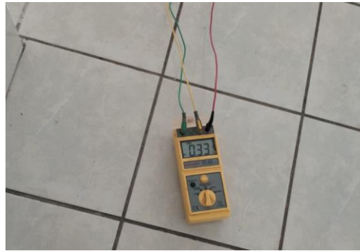
PRUEBA DE RED DE TIERRA QUE CUMPLE
