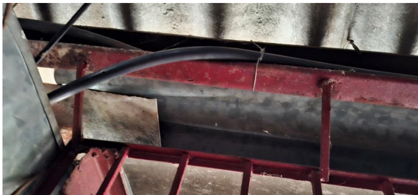
CANALIZACIONES CON POLIDUCTO AUN EN BUEN ESTADO, PERO SUJETA A CAMBIO
