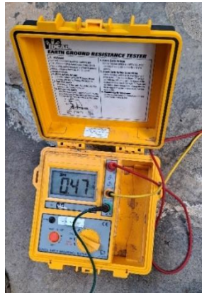
PRUEBA DE RED DE TIERRA QUE SI CUMPLE
