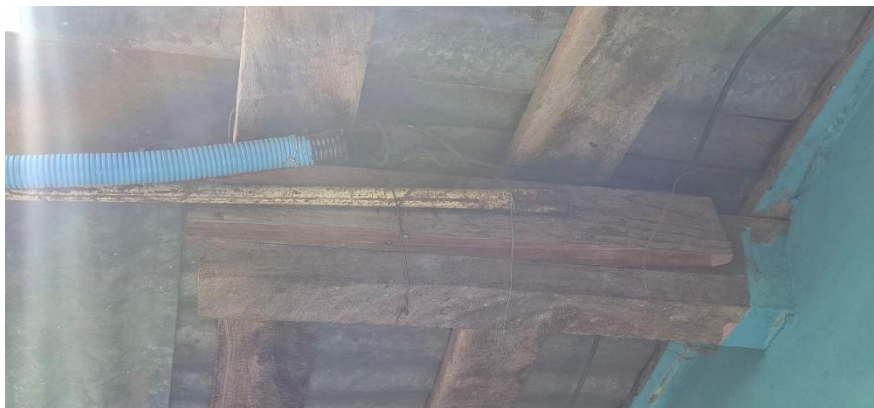
UNA PARTE CARECE DE CANALIZACION
