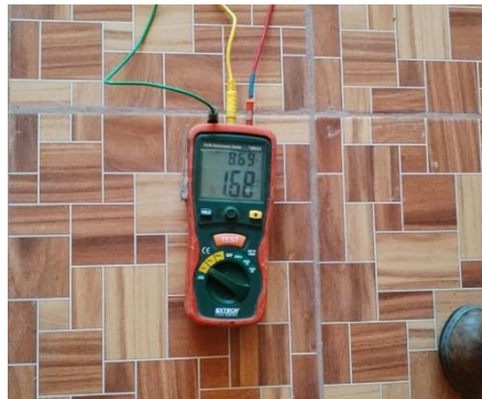
PRUEBA DE RED DE TIERRA QUE CUMPLE
