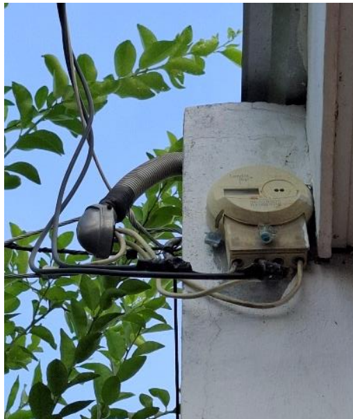
ACOMETIDA PRINCIPAL CABLES EN BUEN ESTADO
