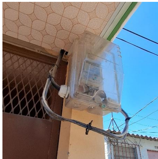
ACOMETIDA PRINCIPAL EN BUEN ESTADO
