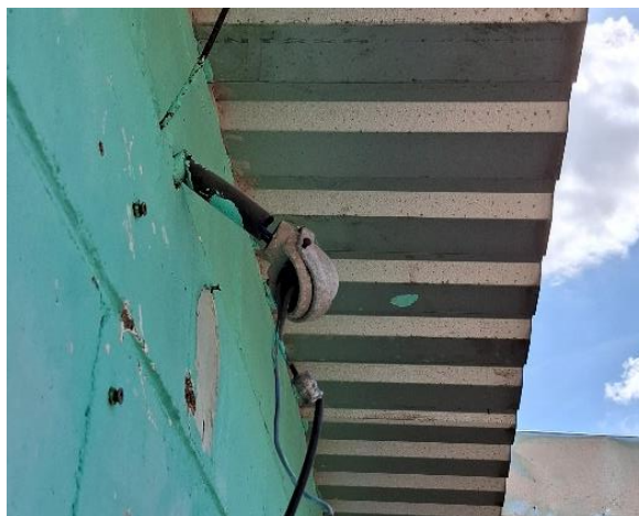
ACOMETIDA PRINCIPAL CABLES EN MAL ESTADO Y CALIBRE MENOR, REQUIERE CAMBIO
