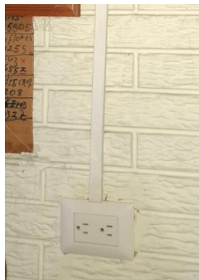
CANALIZACION EN BUEN ESTADO
