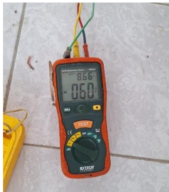
PRUEBA DE RED DE TIERRA QUE SI CUMPLE
