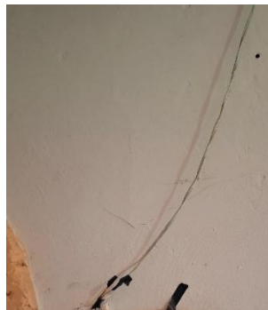
UNAS PARTES CARECEN DE CANALIZACION
