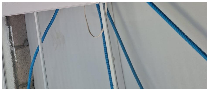
CANALIZACION EN BUEN ESTADO
