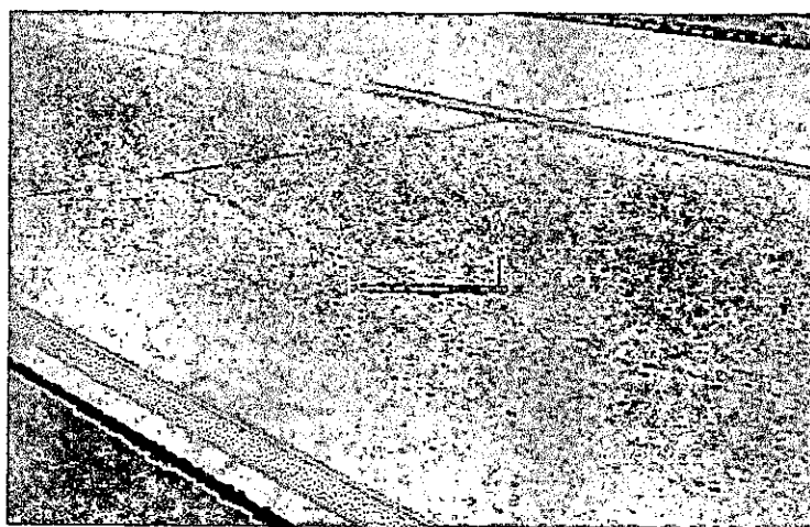
Fig. 2.22 Agrietamiento longitudinal con severidad Moderada.
