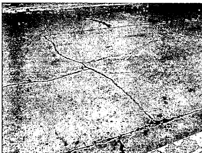
Grietas transversales y longitudinales.
