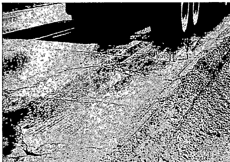
Fig. 2.55 Escurrimiento de agua y bombeo.
