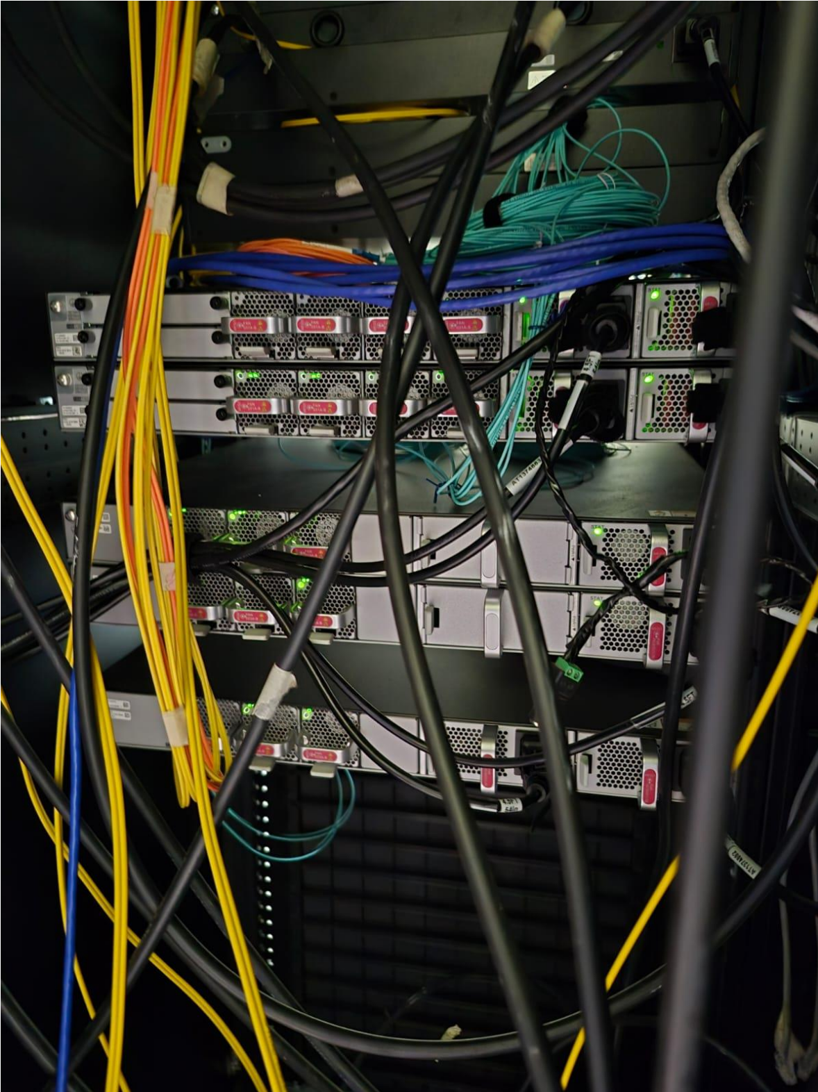
Figura 19: Evidencia de la visita técnica al centro de datos
