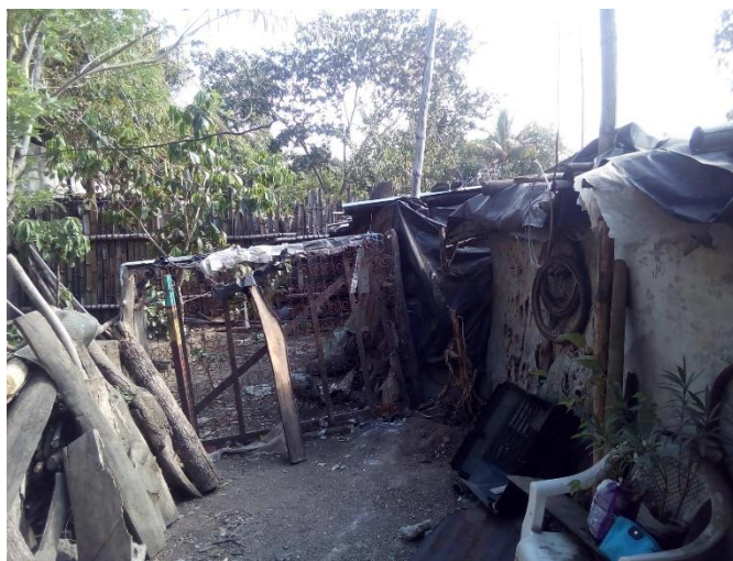
Nota. Vivienda que no cumple estándares de habitabilidad en Comunidad La Empalizada.
