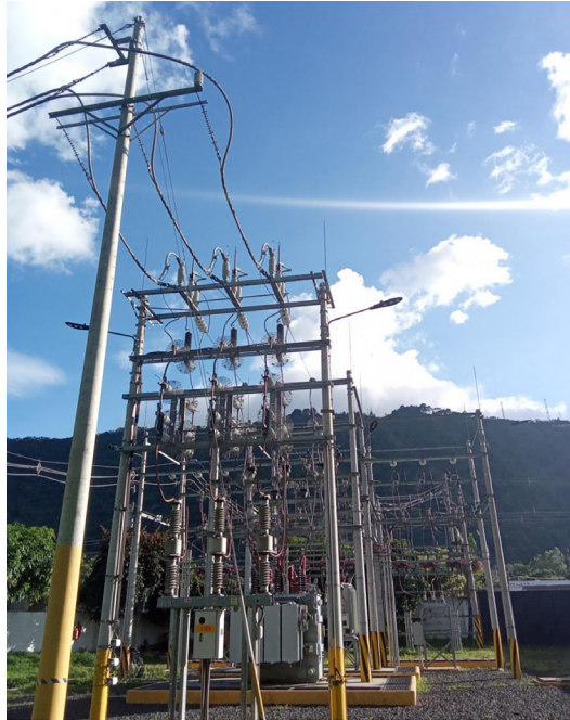
Figura 11. Subestación de Distribución San Marcos: capacidad 40MVA - 46/23 kV
