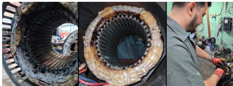
Figura 148. Retiro de hilo acerado de bobinas
