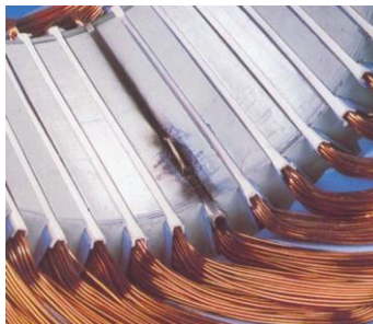
Figura 47. Descargas parciales (DP's) (Velazquez, 2018)
