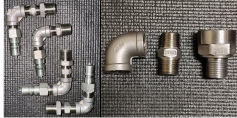
Figura 136. Estado final de los accesorios de interconexión luego de realizar la inspección visual
