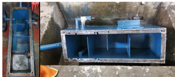
Figura 161. Izquierda: Tanque con partículas y suciedad al fondo. Derecha: Tanque después de limpieza
