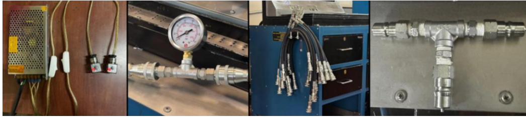
Figura 229. fuente de corriente directa y accesorios de interconexión
