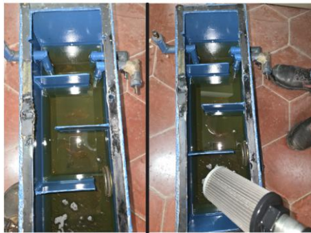
Figura 69. Tanque de aceite sin la tapadera
