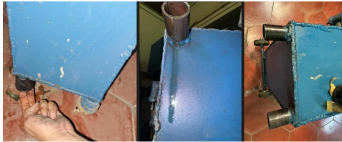
Figura 70. Inspección de fugas de aceite en el tanque de aceite hidráulico
