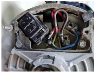
Figura 142. Caja de conexiones
