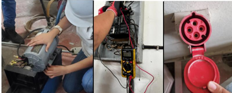
Figura 194. Condiciones para puesta en marcha
