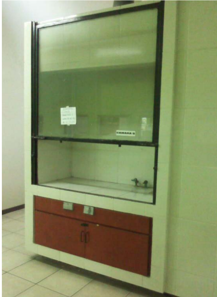
Figura Nº 19. Cámara extractora de gases
