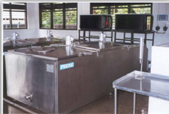
Tanque de almacenamiento
