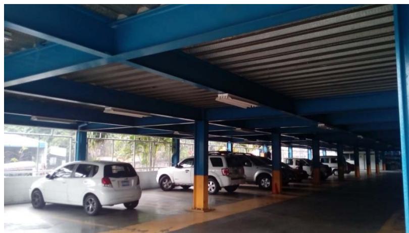
Figura 17: Entrepiso de losas de concreto reforzado coladas sobre tableros de acero (Estacionamiento del colegio Rey de Gloria del Tabernáculo Bíblico Bautista).
