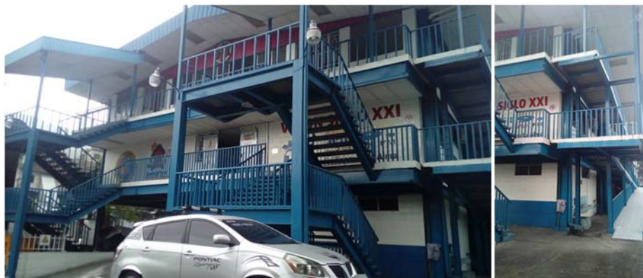
Figura 11: Edificio a base de marcos de acero no arriostrados (Edificio del colegio Rey de Gloria del Tabernáculo Bíblico Bautista).
