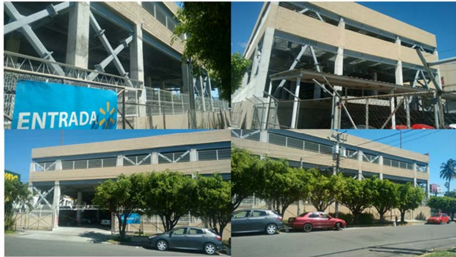
Figura 10: Edificio a base de marcos de acero con arriostramiento concéntrico y excéntrico (Edificio Parqueo de Walmart Escalón).
